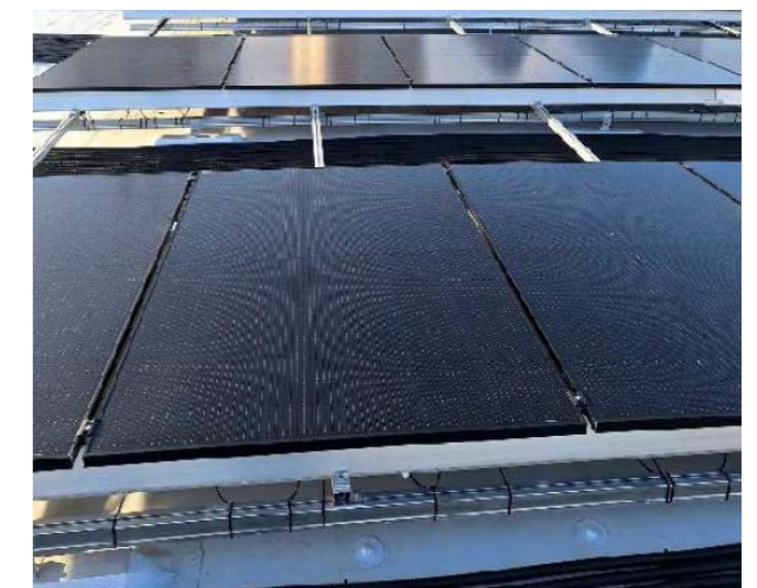
Neu installierte Module und Leitungen auf dem Dach der Sylter Welle
