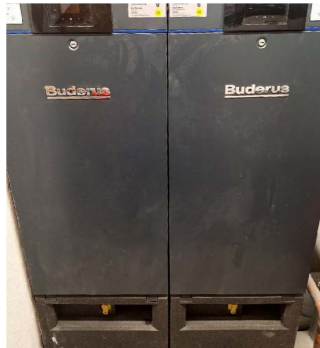
Heiztherme des neuen Sanitärgebäudes auf dem Campingplatz Westerland
