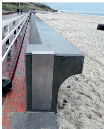
Wandfertigteile mit Wandkopfteil (Vorsatzschale), Blick auf die Promenade auf den bereits ausgebauten Abschnitt 6
